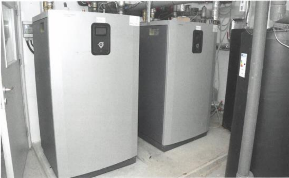
Sørensen setzt die Güllekühlung zum Beheizen seiner Räume und Ställe ein. Die Nutzung dieser Energie erspart ihm jährlich den Einsatz von 80.000 Litern Heizöl.
